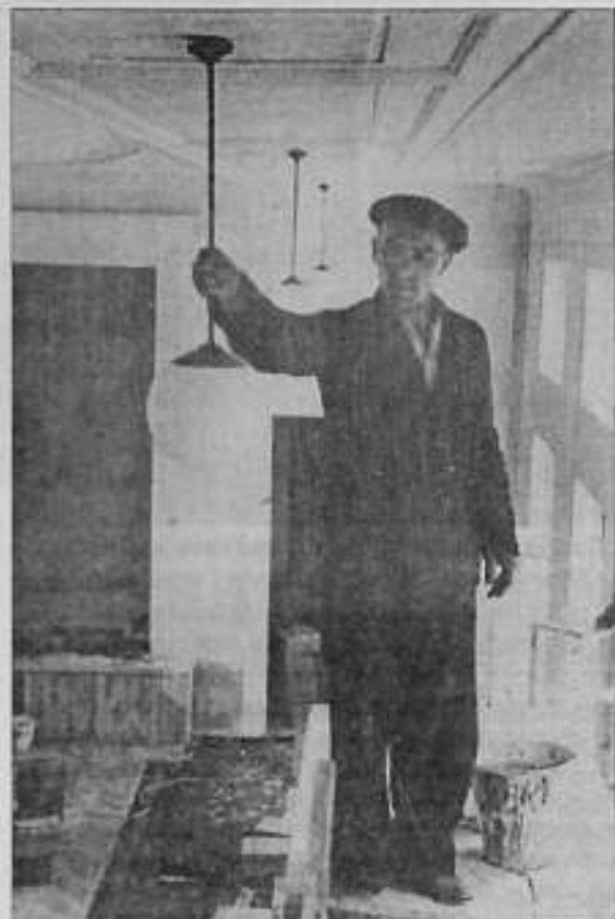
А.Н.Кувыкин ведёт монтаж электрооборудования в клубе-столовой. 1952-53. Фотография. Музей пансионата с лечением «Ишимский».
