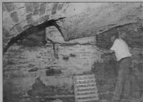
В подвале здания медицинского училища (быв. дом Волкова). Часть помещения засыпана из-за поднятия грунтовых вод. Июнь 2006.
